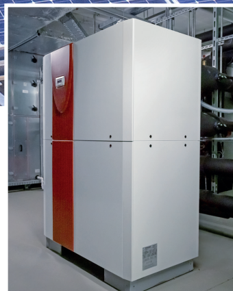
La nostra pompa di calore nell'edificio B.E.G.
